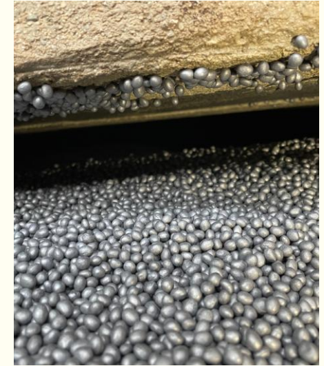
KRUIPRUIMTE ISOLATIE ZEIST
